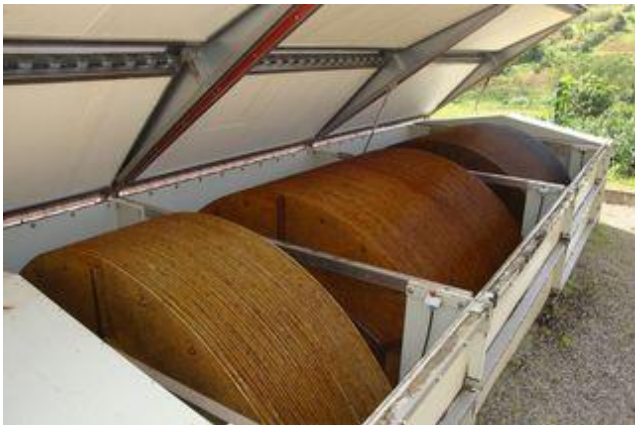
Figure 2.2- Batteries de biodisques
