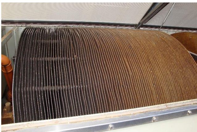
Figure 2.3-Une batterie de biodisques
