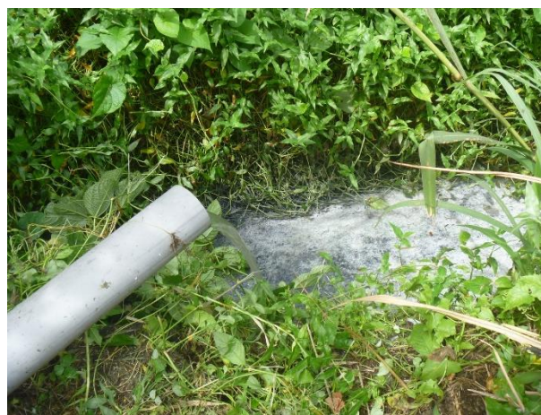
Figure 3.4 - STEP la Fraicheur - rejet des eaux traitées
