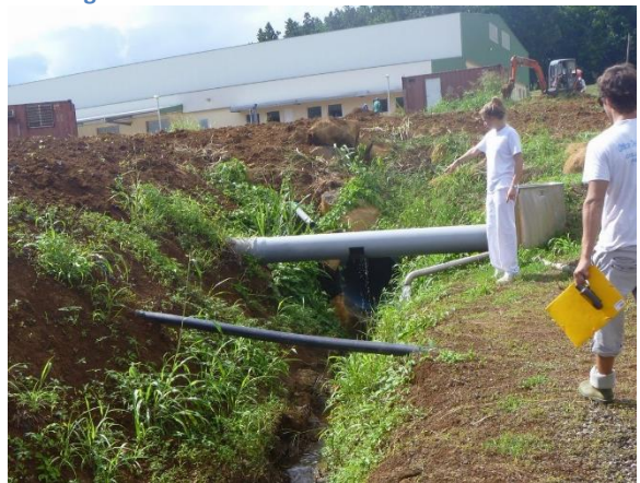
Figure 3.8 - Canalisation, ravine et regard de répartition
