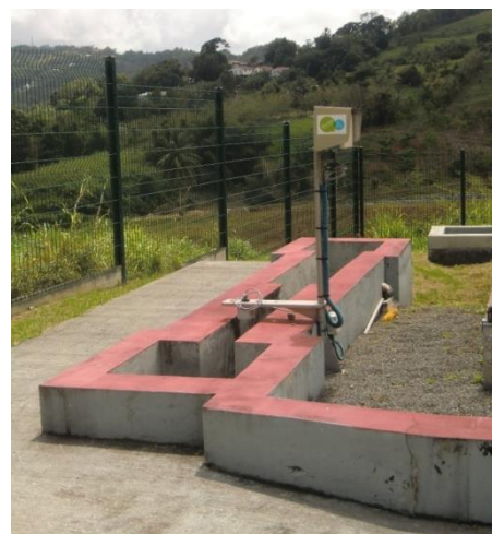
Figure 2.4 - Canal venturi en sortie
