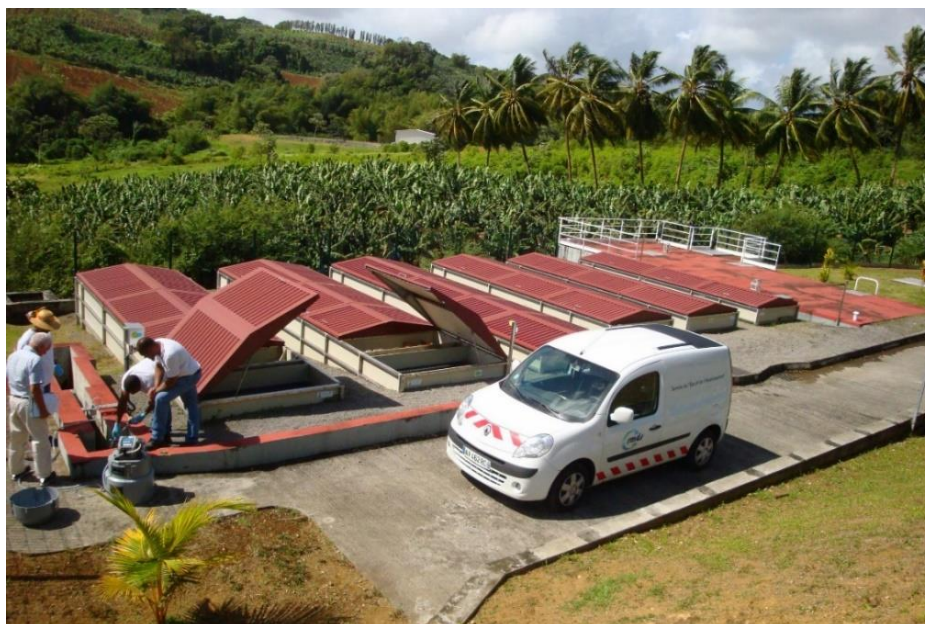
Figure 1.1 - Batteries de biodisques
