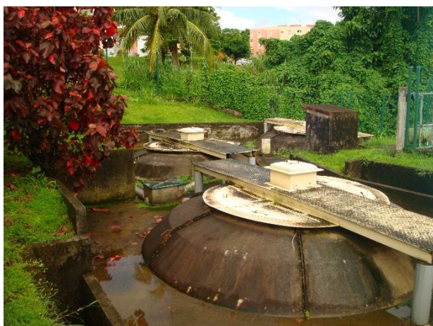
Figure 3.3 - STEP la Fraicheur - 2 bassins d'aération
